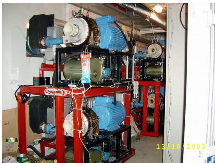
Рис. 3 Модули центробежных компрессоров в контейнере
