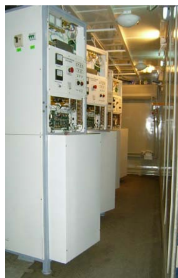
Рис. 4 Модули источника питания в контейнере
